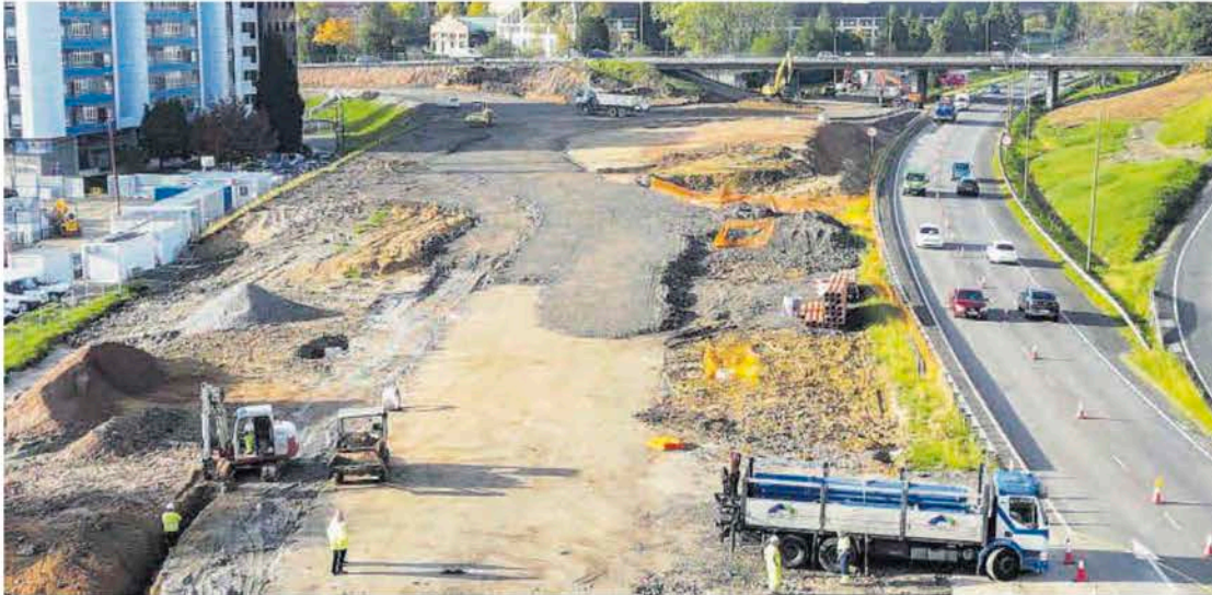
Vista de las obras de la nueva entrada a Oviedo por la A-66. | Cedida a LNE
