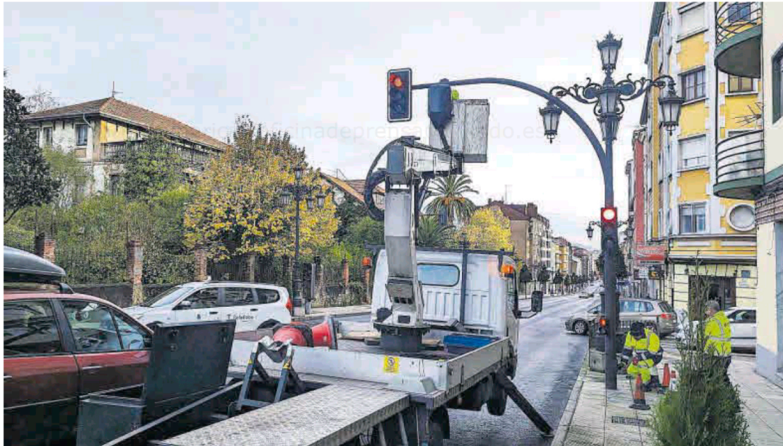
Colocación de las balizas en un semáforo. | Cedita a LNE
